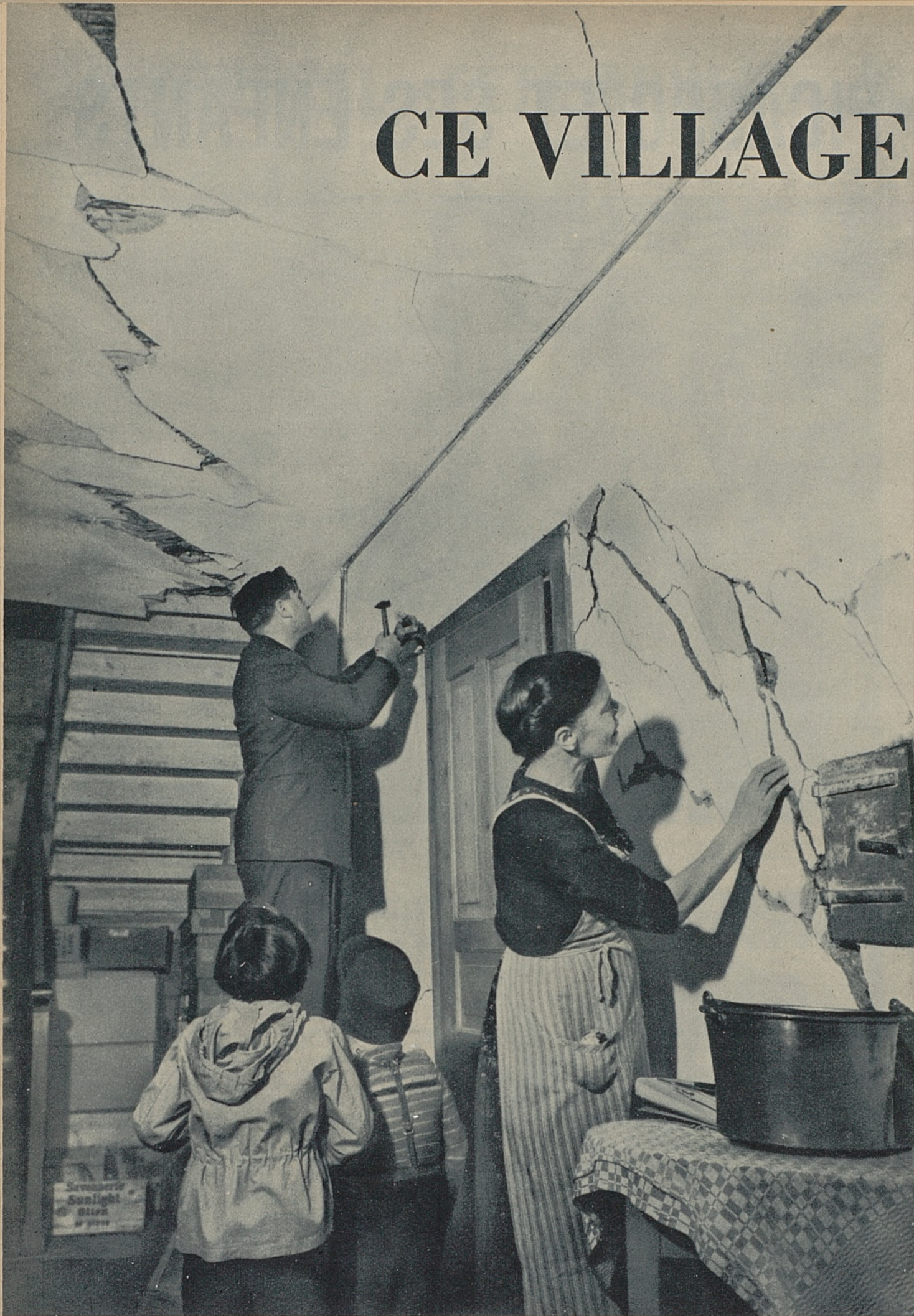
Tel est l'aspect de la plupart des maisons de Peiden, aux plafonds et aux murs consolidés, que l'on y puisse au moins vivre. Mais la formation continue de nouvelles lézardes prouve que le glissement se poursuit lentement, inexorablement. L'existence dans de telles conditions, c'est une suite d'heures faites d'angoisses incessantes.
