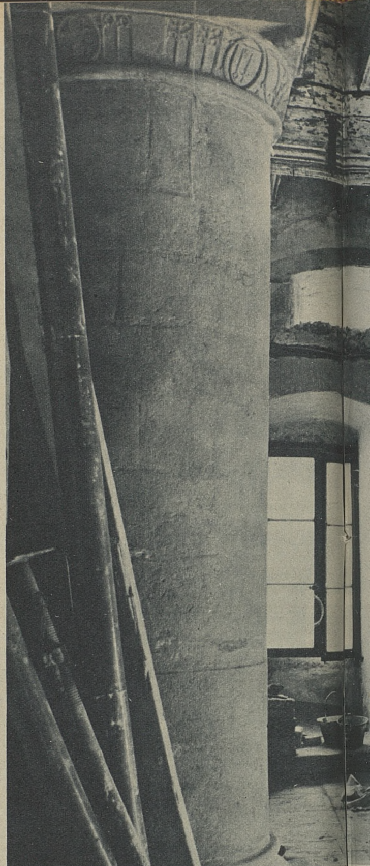
Au rez-de-chaussée du corps principal du bâtiment, Mme Drilhon examine l'état actuel de ce qui fut son trois-pièces, confort. La grande colonne de gauche est
